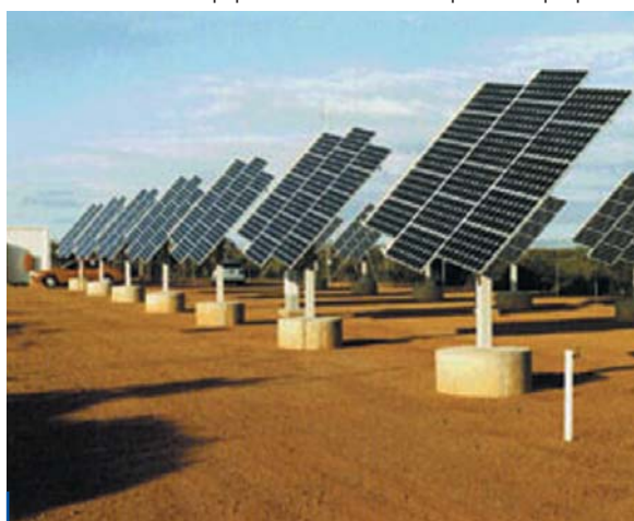
Συστοιχία φωτοβολταϊκών για την παραγωγή ηλεκτρικής ενέργειας από την ηλιακή ενέργεια
